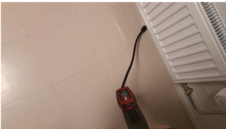
Lattian ja ulkoseinän rajapinnasta tapahtui ilmavuotoa sisäilmaan.
