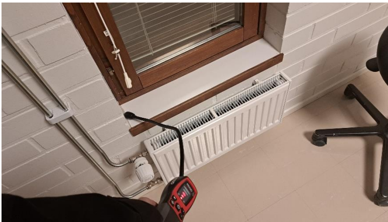
Ikkunapenkistä havaittiin ilmavuotoa sisäilmaan.
