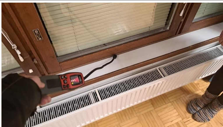
Ikkunapenkistä havaittiin ilmavuotoa sisäilmaan.
